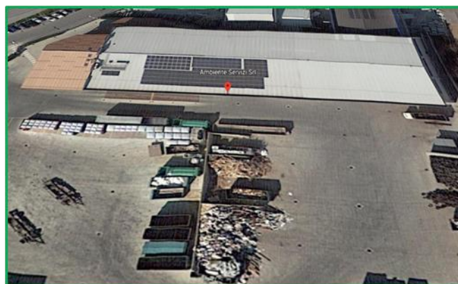
Figura 21 – Impianto fotovoltaico installato presso la sede operativa AMBIENTE SERVIZI
